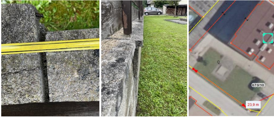
Beispielfoto 6: Darstellung Setzung der Stützmauer + betroffene Länge
