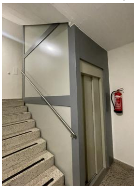
Beispielfoto 2: Aufzugsanlage in der Tiwagstraße 14
