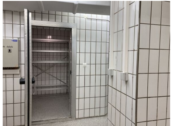
Begehrter Kühlraum samt Regal
